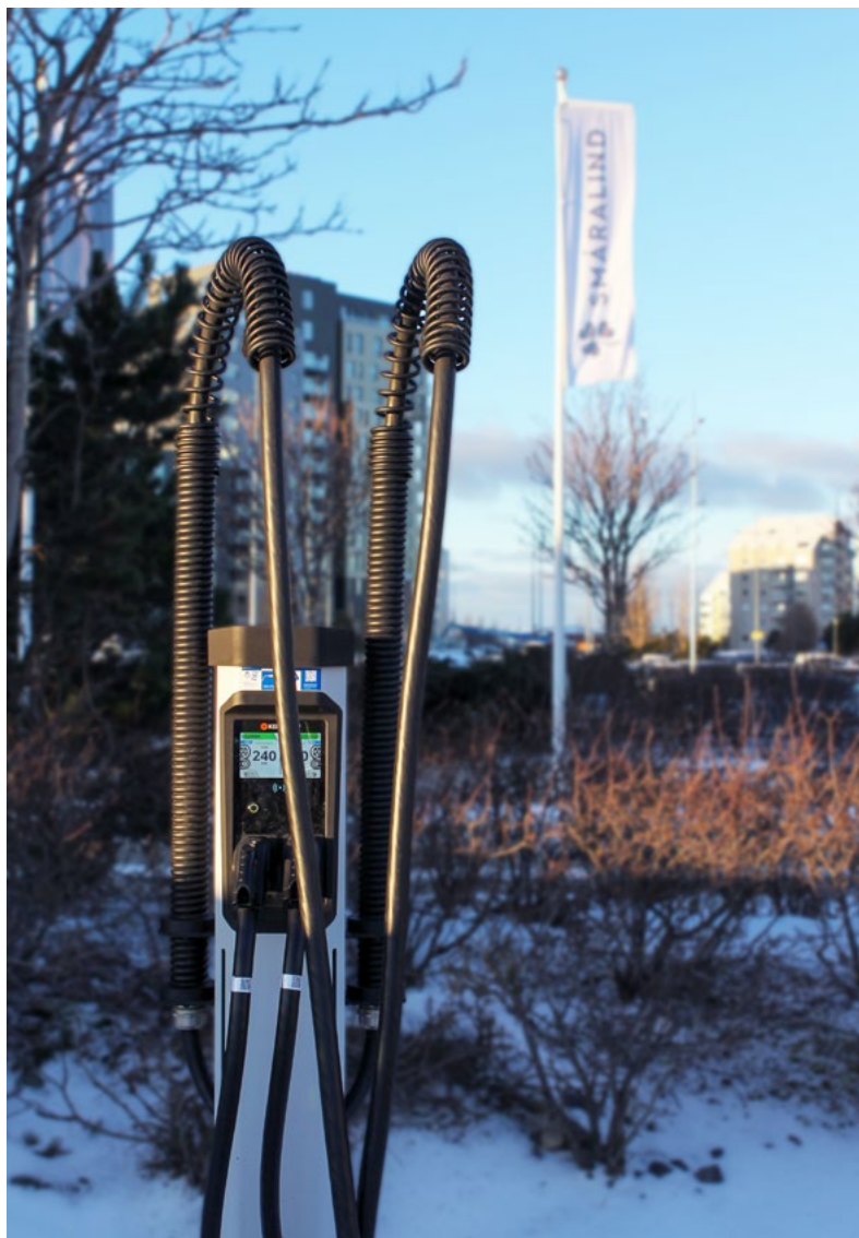
Hraðhleðslustöð við Smáralind
